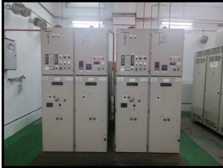
VCB PANEL 11KV DI BLOK SP9
